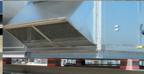
Klimagerätelagerung auf Bürogebäude
